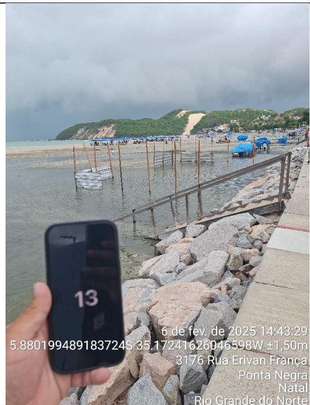
Figura 35 – Início do tapume no dissipador D13 e acúmulo de água.
