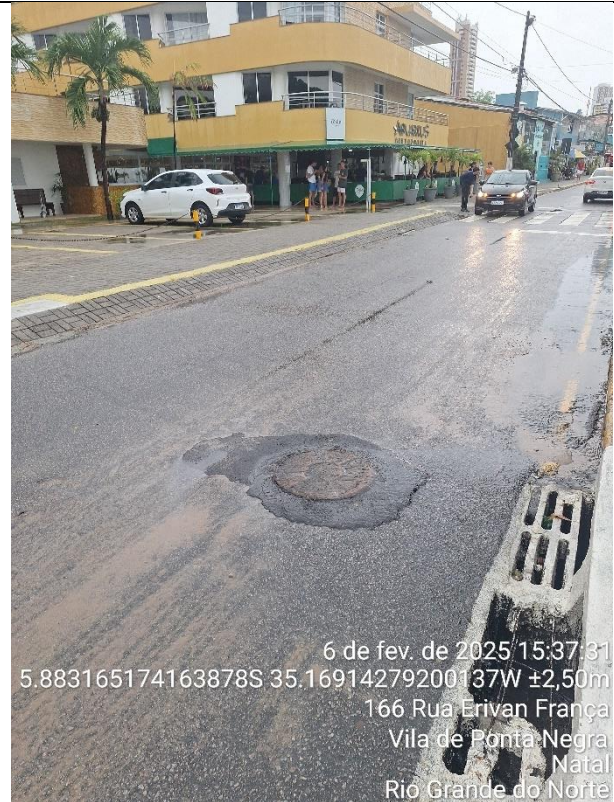
Figura 37 – Poço de Visita de Esgoto transbordando durante chuva.
