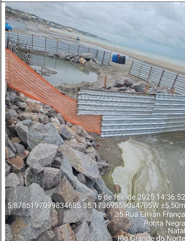
Figura 34 – Esgoto nas proximidades do D11.
